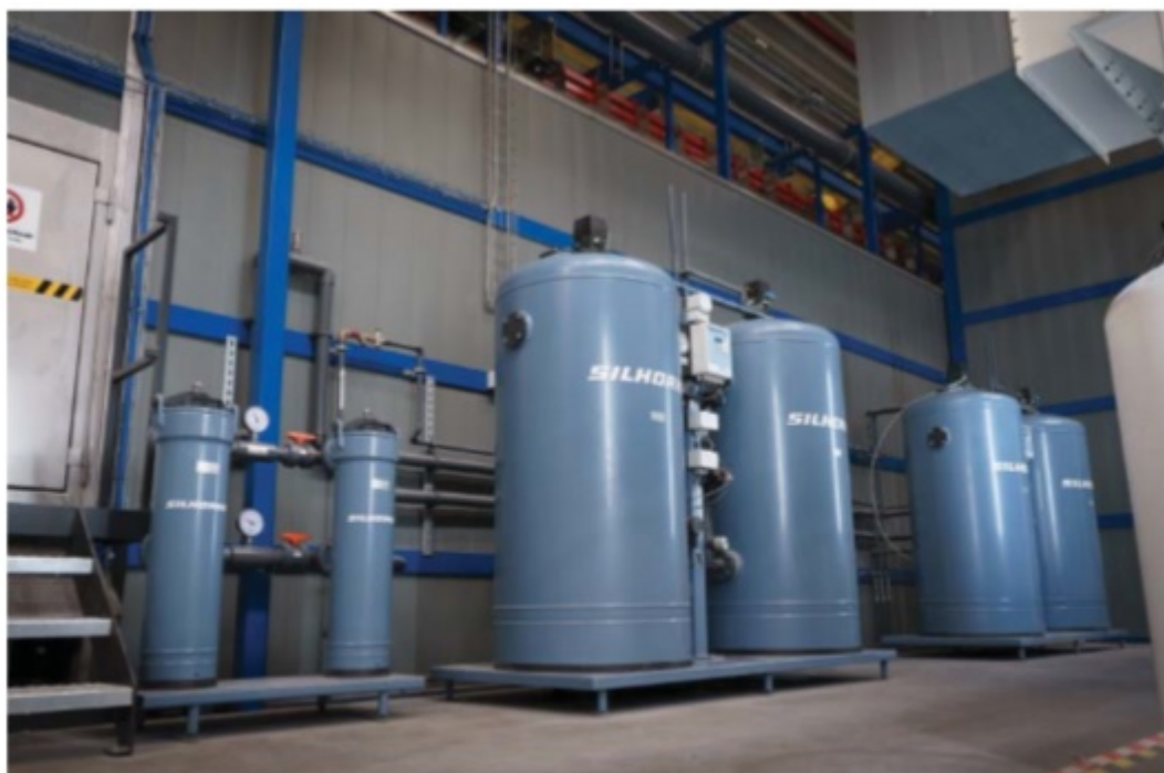
Фото. 7. Вода DI для предварительной бесхромной обработки. Промывную воду рециркулируют через ионообменные деминерализаторы. Впереди два мешочных фильтра для удаления механических примесей. Если присутствуют органические вещества, в наличии имеются специальные фильтры с активированным углем.
