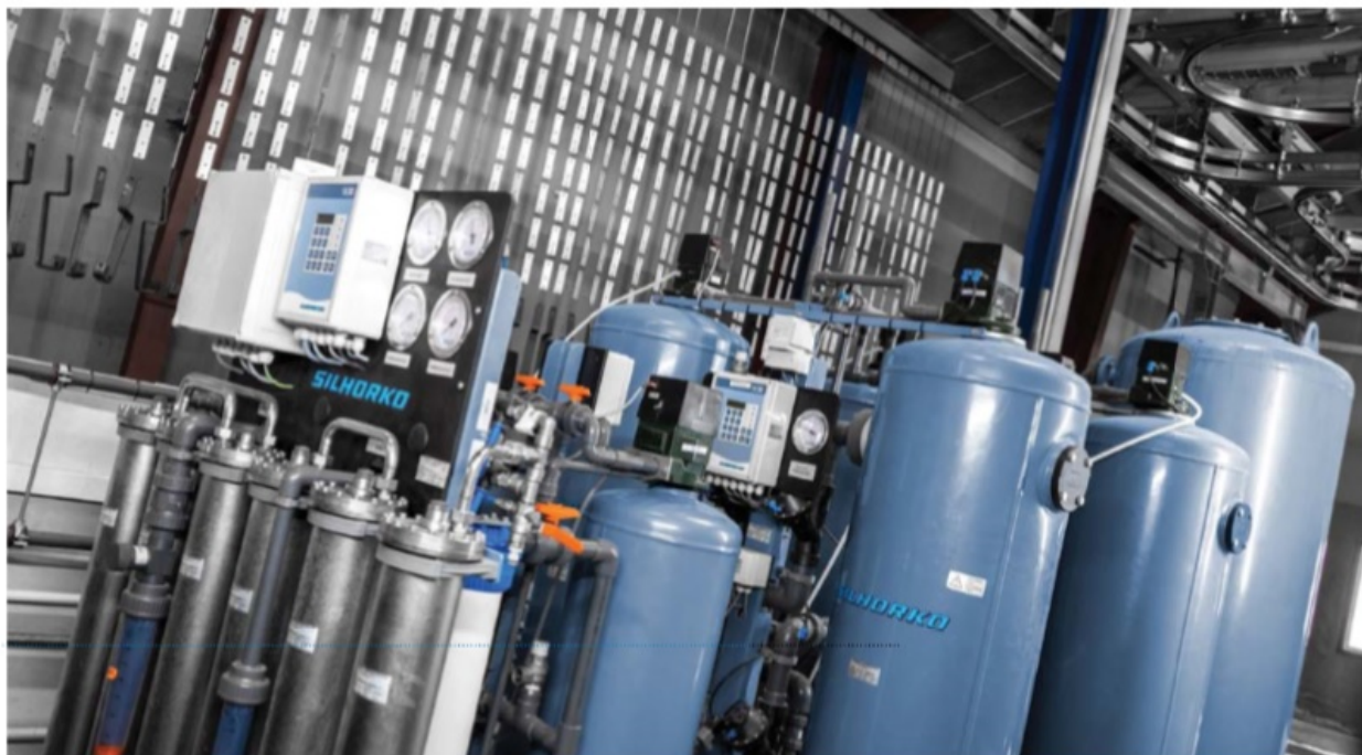
Фото. 4. Бесхромная предварительная подготовка алюминия DI водой. Установка для подачи подпиточной воды состоит из станции умягчения и обратного осмоса. Рециркуляционная часть включает фильтрацию воды активированным углем и деминерализацию на ионообменниках.
